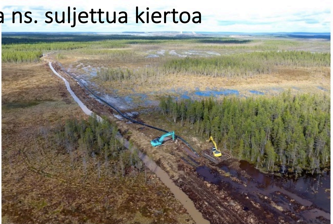
Kittilän kultakaivoksen jätevesien purkuputki tulee horisontissa näkyvältä kaivokselta. Rakentaminen aloitettiin tammikuussa 2020. Kuva: Jarmo Honkanen / Yle
